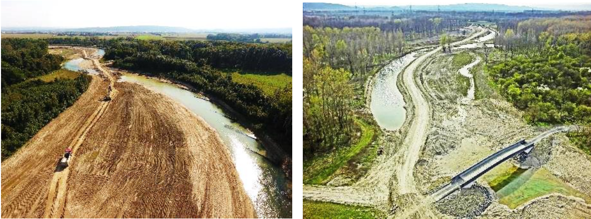
Abb. 18: Korridor des neuen Flussbetts inklusive der Uferzonen und Umlandabsenkungen im Bauabschnitt 3 während der Bauarbeiten im Jahr 2016
