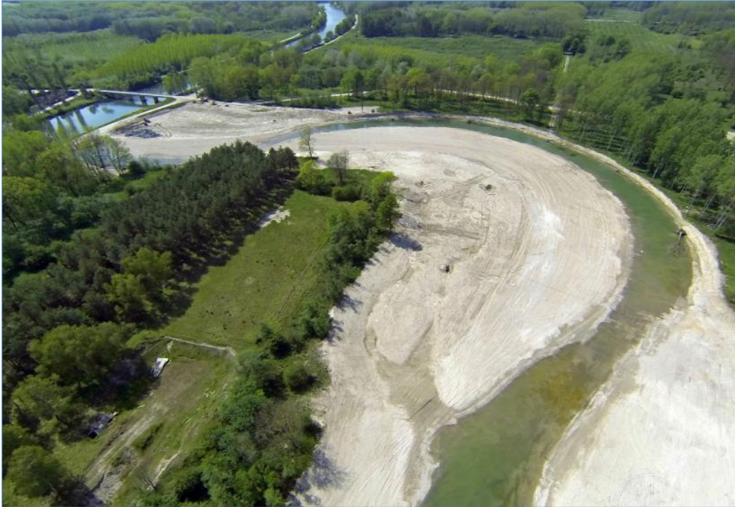
Abb. 9: Flussbett mit noch unbewachsenen Au-Bereichen. Das Gelände ist grob nach Plan modelliert und wurde in weiterer Folge für eine ökologisch vielfältigere Gestaltung feinmodelliert. Der Bauabschnitt ist noch nicht durchflossen, die sichtbare Wasserfläche ist das anstehende Grundwasser.
